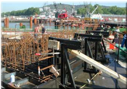
Élément préfabriqué en forme de « pétale » prêt à être bétonné (vu sous un autre angle)
