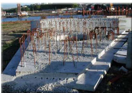
Élément porteur avec sa réserve circulaire par laquelle passera le pieu métallique d'1,40 m de diamètre
