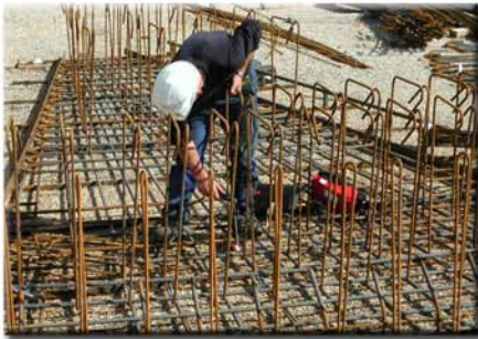
Construction des cages d'armature pour une pièce préfabriquée du gabion en forme de « pétale »
