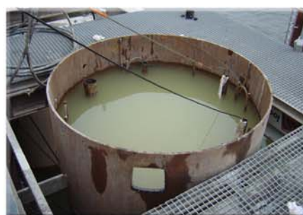
Sondes d'auscultation mises en place dans les tubes d'un diamètre de 0,60 m en périphérie de la cage d'armature
