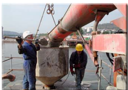
Opération de bétonnage d'un pieu d'un diamètre d'1,80 m, qui s'effectue dans sa totalité sans interruption
