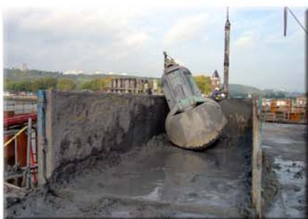
Benne preneuse posée dans la benne où sont vidés les matériaux de forage avant leur évacuation en dépôt
