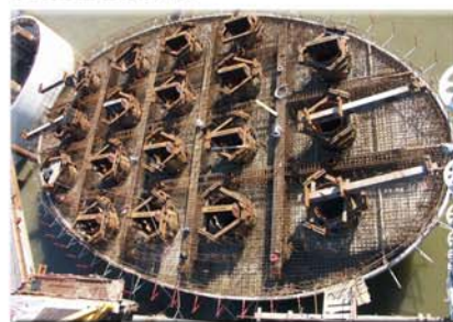
L'ensemble est ensuite ferrillé, pour permettre le coulage d'une première épaisseur de béton de 30 cm
